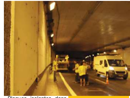
Plaques isolantes dans un tunnel
